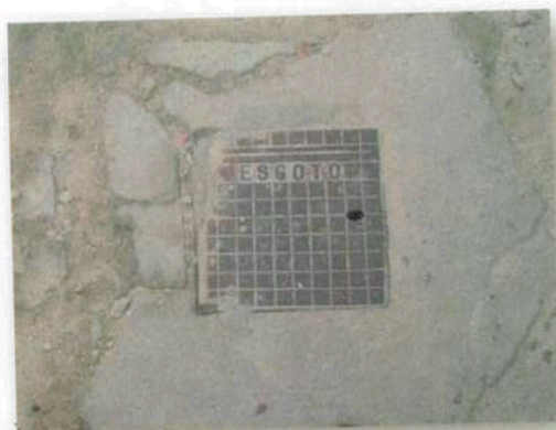
Figura 17: Caixa de ligação de esgoto.
