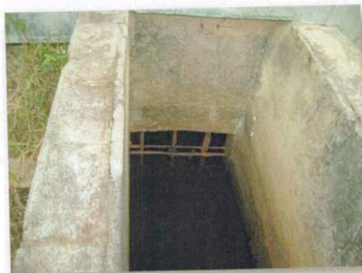
Figura 8: Grade de chegada de água bruta.
