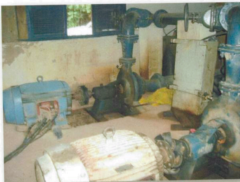
Figura 9: Conjunto moto-bomba e barrilete da EEAB.
