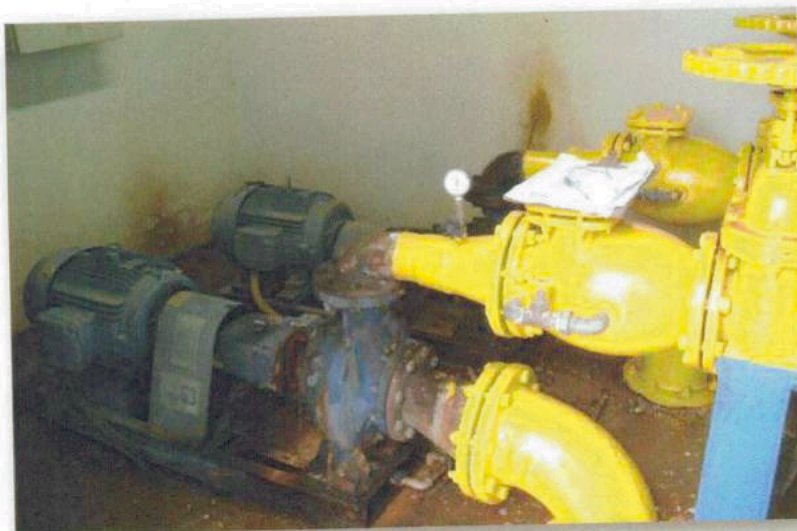
Figura 15: Conjunto moto-bomba da EEAT.
