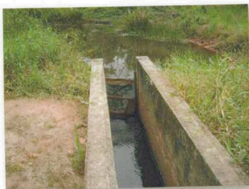
Figura 7: Canal de captação de água bruta.
