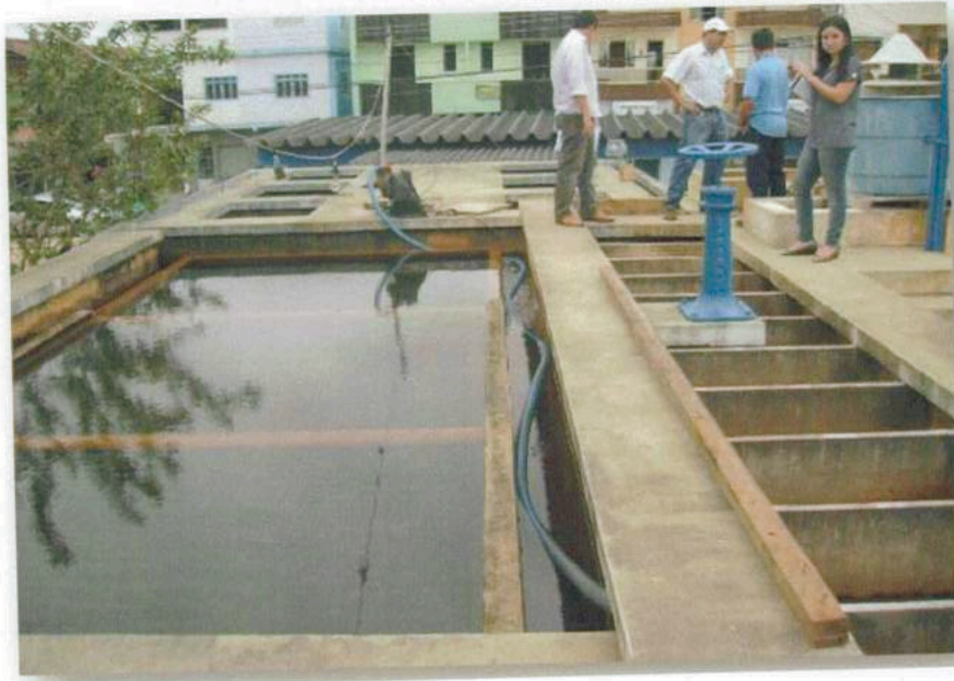
Figura 13: Vista do decantador e filtros.
