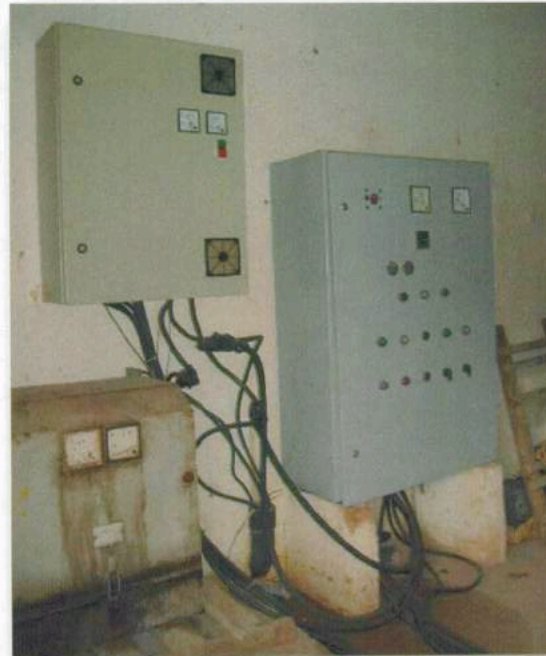
Figura 10: Pannel elétrico da EEAB.
